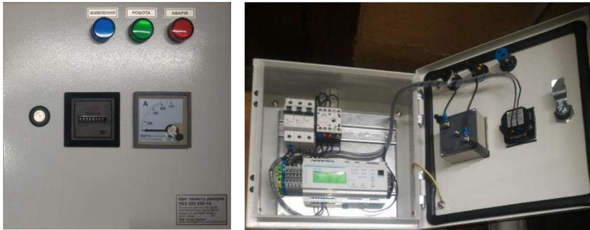
Рисунок 2.11 – Шафа захисту електродвигуна УВЗ-303-250-1А
