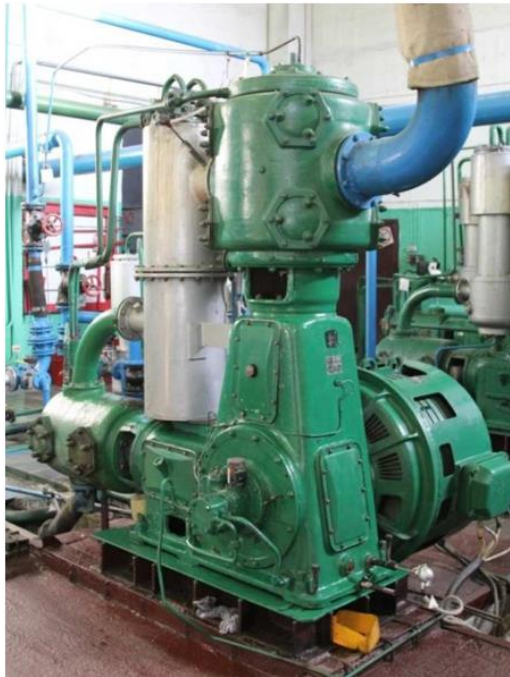
Рис. 4.2. Компресор ВП 20/8 МУ4, встановлений в компресорній ЖЗСП
