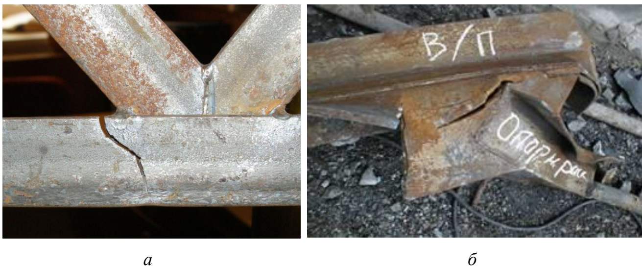
Рисунок 1.9 – Пошкодження у вузлах, які зумовили руйнування безфасонкової ферми (а) і ферми з фасонками (б)
