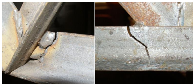
Рисунок 2 – Втомне пошкодження вузла ферми в зоні термічного впливу від зварювання
