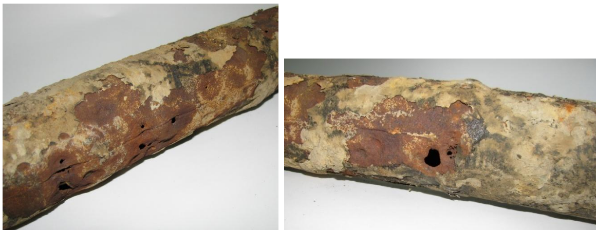
Рис. 1. Фрагменти сталі труби підземного газопроводу низького тиску (Ø 60 мм) з наявними електрокорозійними дефектами типу «свищ»
