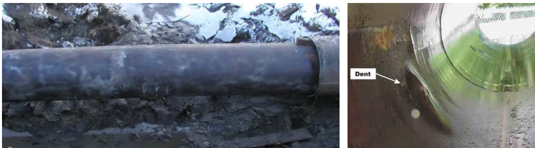
Рис. 3 – Приклади деформацій стінок трубопроводів
