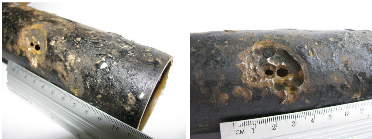
Рис. 2. Фрагменти сталі труби підземного газопроводу низького тиску з характерними ознаками електрокорозійного пошкодження вирізані в місці аварійного витoku природного газу
