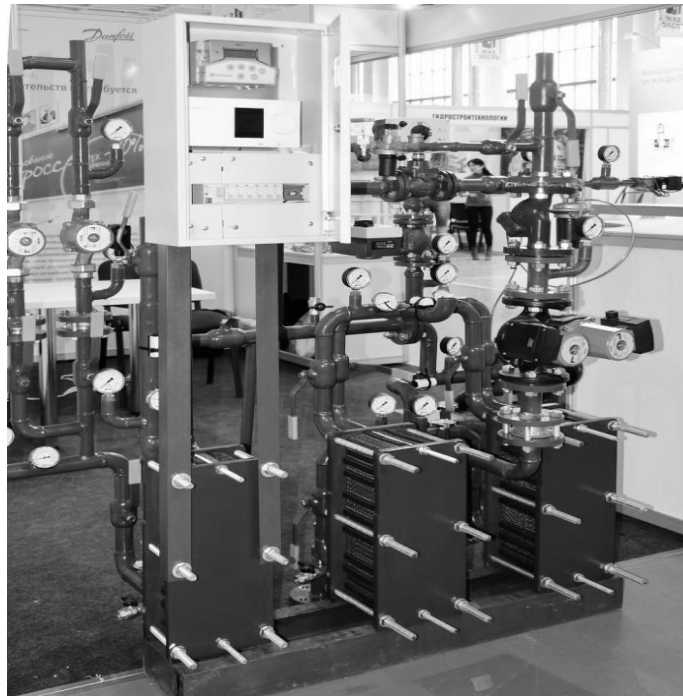
Рис. 9.9. Загальний вигляд блочного теплового пункту з системою автоматичного регулювання теплоспоживання
