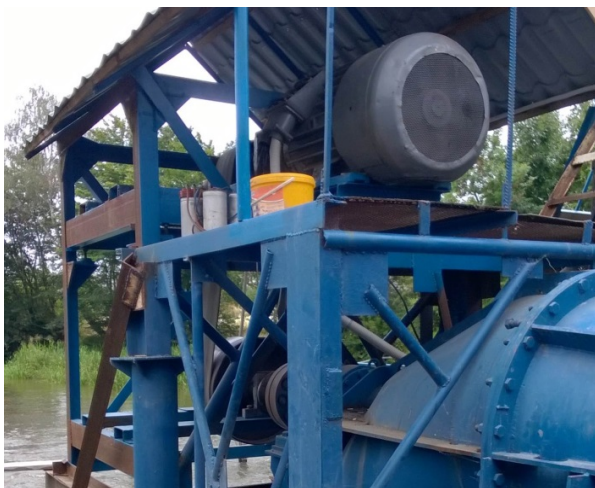
Рис. 2. Гідроагрегат першої черги Бережанської мікроГЕС (гідротурбіна Т-90 ТОВ «Мінігідро» (у нижньому правому кутку), асинхронний електрогенератор потужності 75 кВт (зверху), пласкоремінна передача Nabasit (на задньому плані)
