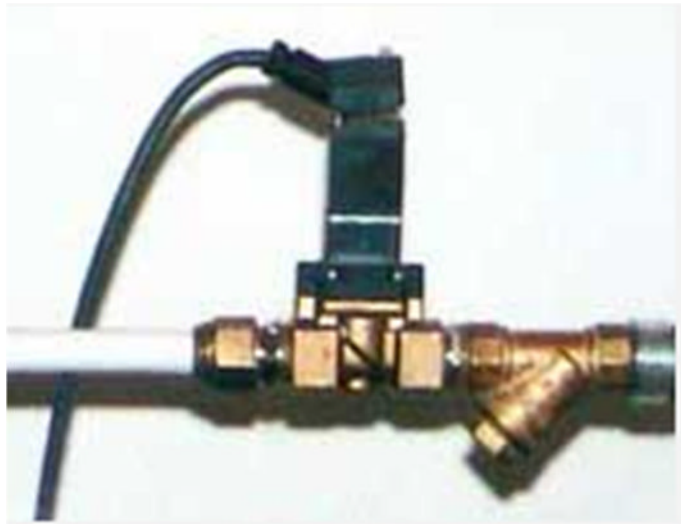
Рисунок 3.4 - Вид клапана перекриття водопостачання, змонтованого на відвідній труби
