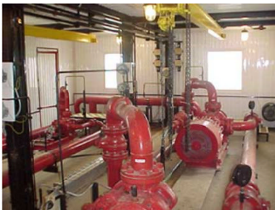
Рисунок 3.7 – Вигляд водяної установки пожежогасіння
