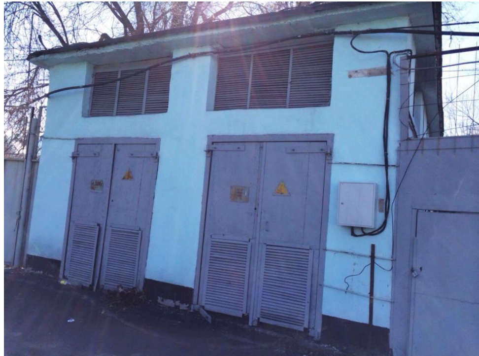
Рисунок 2.1 – Зовнішній вигляд ТП-10/0,4 кВ.
