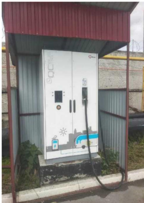
Рисунок 2.4 Станція для зарядання електробуса
