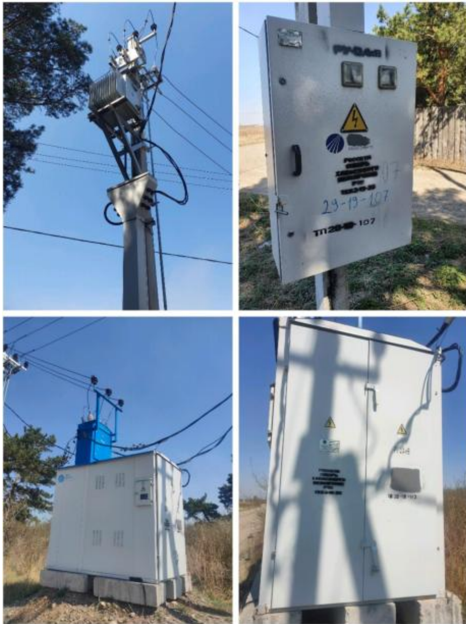
Рисунок 1.3 – Обладнання, яке можна зустріти на території дачного масиву (КТП щоглового та кіоскового типу)
