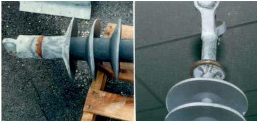
Рисунок 1 - Пошкодження наконечників ізолятора внаслідок горіння дуги
