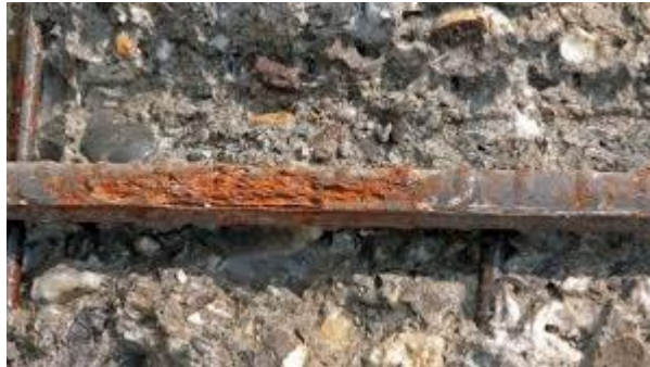
Рисунок 3.3 – Корозія стержні у місці руйнування захисного шару
