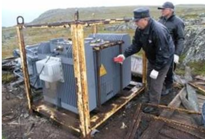
Рисунок 2.2 – ТЕГ для живлення екологічних приладів на невеликому безлюдному острові Фейрвей-Рок на Алясці
