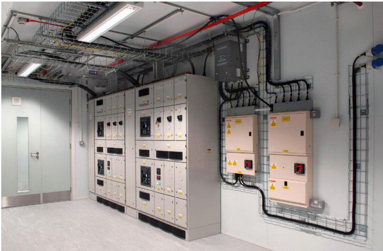
Рисунок 1.2 – Електрощитова сучасного багатоквартирного будинку
