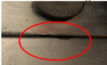
Рис. 1. Пошкодження антикорозійного цинкового покриття металевих конструкцій в умовах експлуатації
