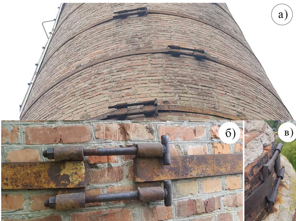
Рис. 3.4 – Дефекти стяжних кілець : а) загальне фото стяжних кілець; б) корозія замка металевого кільця; в) корозія замка металевого кільця вид збоку
