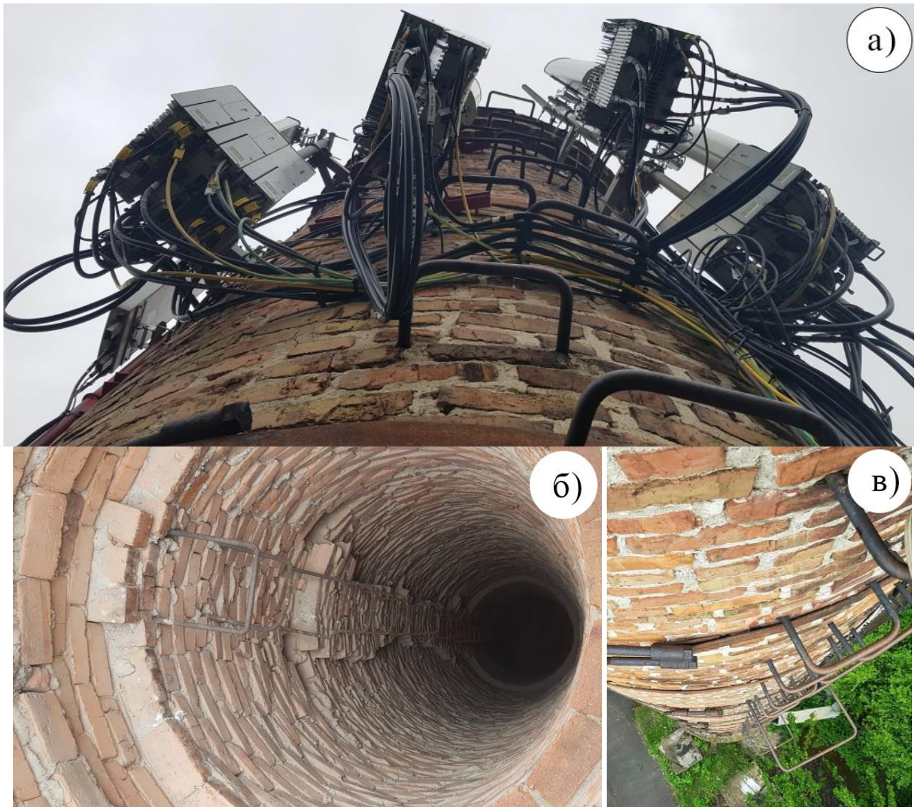
Рис. 3.5 – Дефекти гарнітури цегляної димової труби : а) обладнання закріплене на трубі; б) внутрішня частина труби; в) вигляд труби зверху
