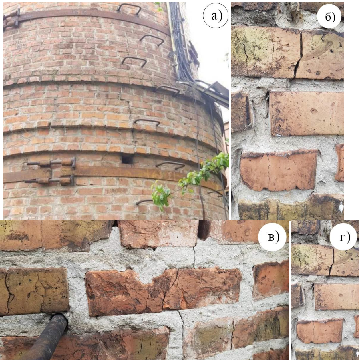
Рис. 3.2 – Дефекти стовбура димової труби : а) тріщина в місці кріплення сходинок; б) розкриття тріщини; в) дефект цегляної кладки; г) тріщина в цеглі
