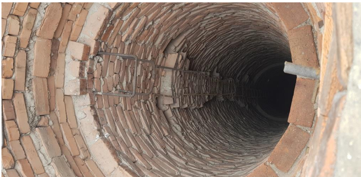
Рис. 3.3 – Дефекти стовбура димової труби
