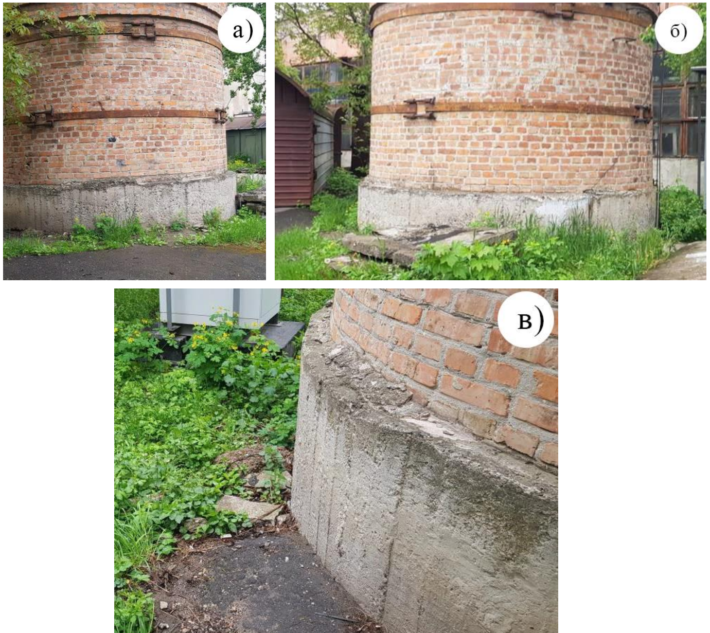
Рис. 3.1 – Дефекти фундаменту : а) загальне фото фундаменту; б) тріщини в основі фундаменту; в) обмостка фундаменту;
