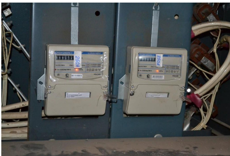
Рисунок 2.3 – Прилад комерційного обліку електричної енергії встановлений у ВРП – 0,4 кВ навчального корпусу №3
