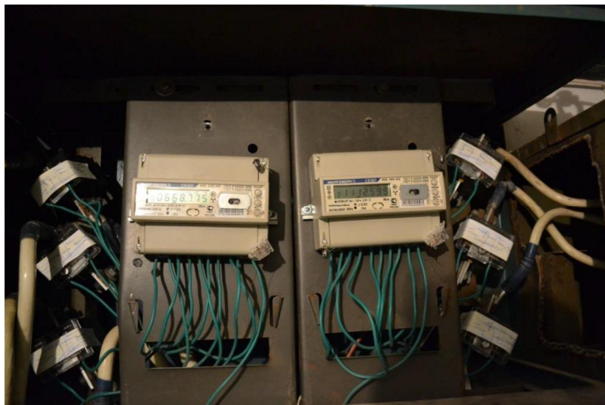
Рисунок 2.2 – Прилад комерційного обліку електричної енергії встановлений у ВРП – 0,4 кВ навчального корпусу №2
