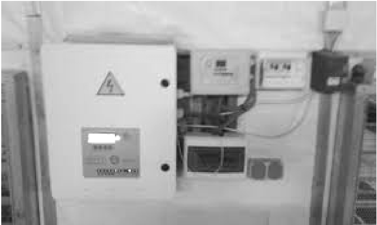
Обладнання для забезпечення мікроклімату тваринницьких ферм
