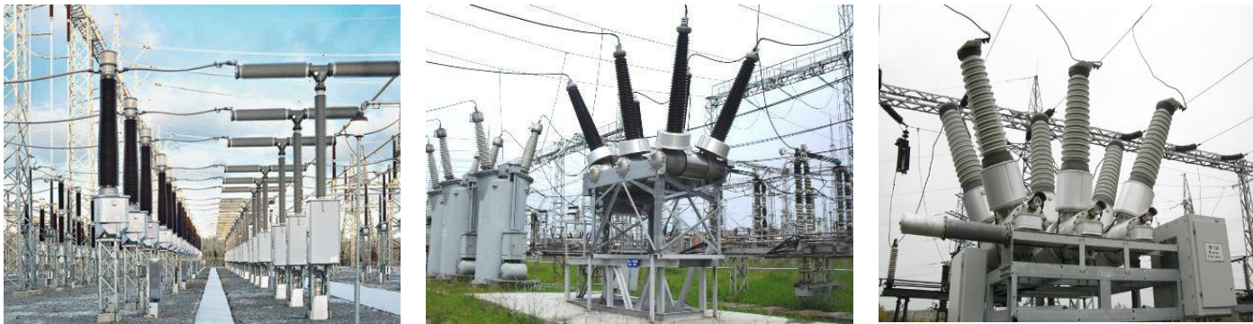
Рисунок 3.1 - Високовольтні вимикачі різних типів й номіналів та їх розміщення на підстанції
