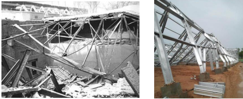
Рисунок 4.1 – Аварії несучих конструкцій
