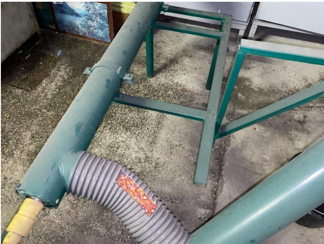
Рисунок 6.28 – Загальний вигляд пересипного патрубку гвинтового завантажувача з пересипом з багатокомпонентною сумішшю після виконання змішування
