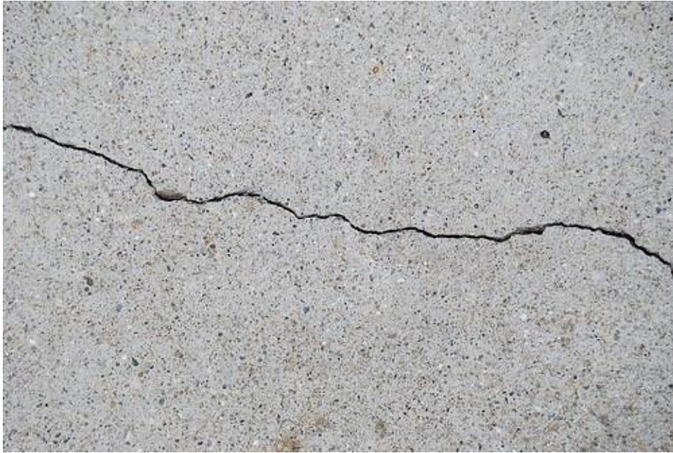
Рис. Характер руйнування плити серії 1 марки П 2.1
