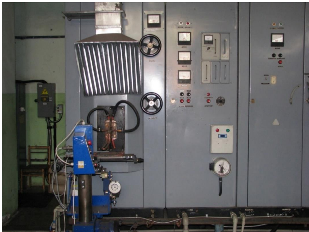
Рисунок 2.3 Загальний вигляд генератора ВЧГЗ – 100/0,44
