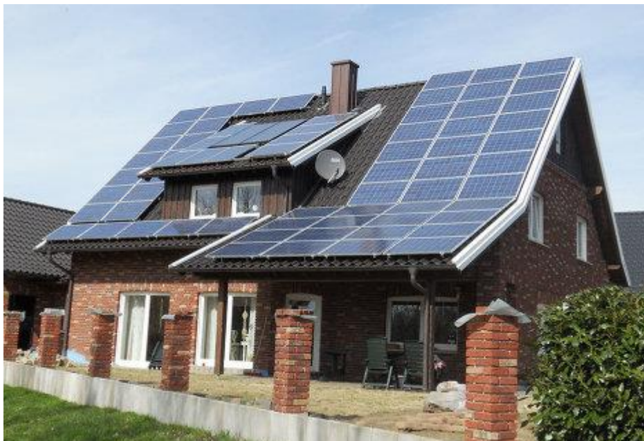
Рисунок 3.7 - Будинки з похилим колектором, розташованим на даху будівлі
