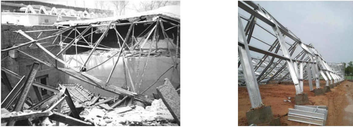
Рисунок 4.1 – Аварії несучих конструкцій
