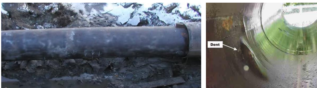
Рис. 3 – Приклади деформацій стінок трубопроводів
