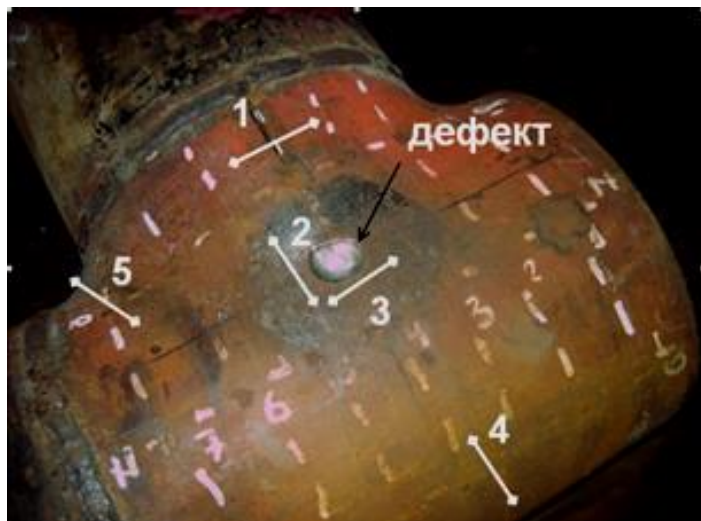
Рис.1. Загальний вигляд трійника з штучним дефектом (стрілками показано напрямки вирізки лабораторних зразків в досліджуваних зонах 1, 2, 3, 4, 5).
