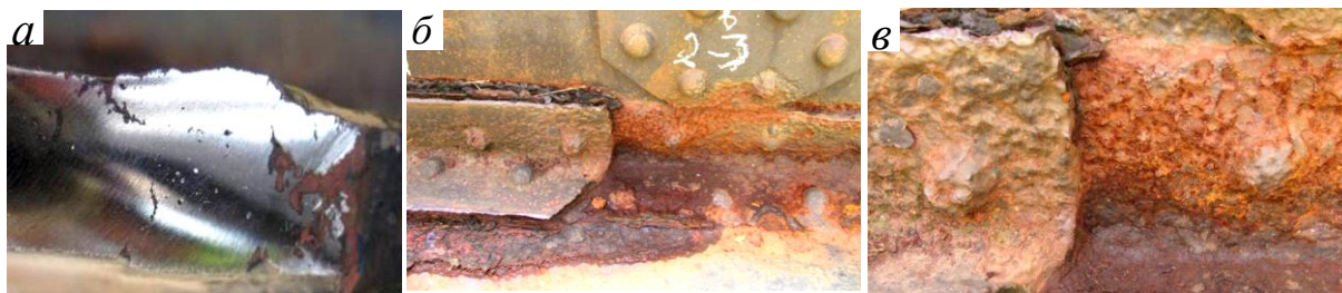
Рис. 1. Тріщини в поперечному перерізі зварного шва між опорним кутником та найнижчим горизонтальним обрусом (а) та корозійні ураження на його поверхні (б, в).
