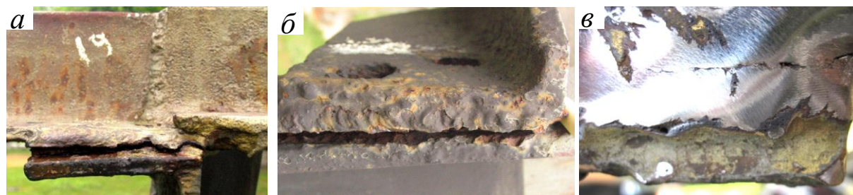
Рис. 4. Пошкоджені зварні з'єднання між кронштейном на опорному кутнику та коловим обручем другого ярусу (а), між кронштейном та опорним кутником (б) та типове корозійне розтріскування зварного з'єднання (в).
