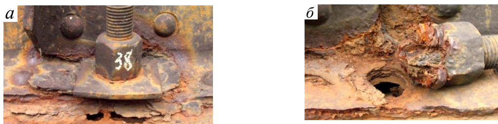
Рис. 6. Наслідки затікання води в зону натягу анкерних болтів (а) та їх руйнування внаслідок сумісного впливу навантажень від натягу болта та корозивного середовища (б).
