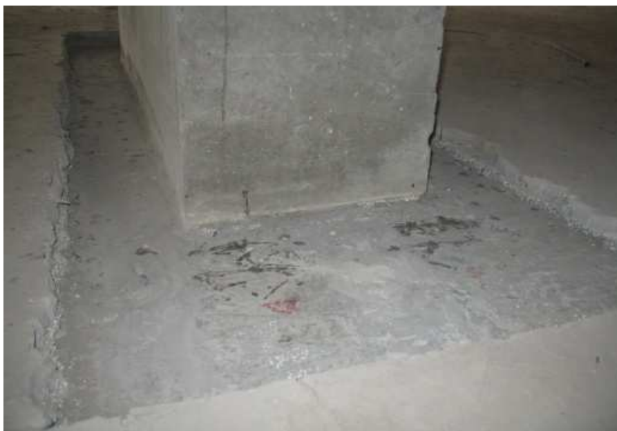
Рис. 42. Підготовка припорної ділянки до подальшої аплікації вуглецевих стрічок CFK Lammelen: a – фрезкування бетонних поверхонь; b – підготовлена поверхня під аплікацію вуглецевих стрічок
