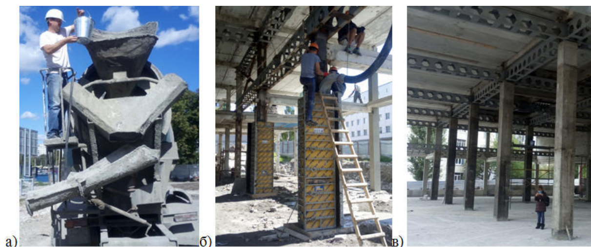
Рис. 2. Бетонирование колонн из самоуплотняющегося бетона: а) второй этап введения суперпластификатора; б) бетонирование усиления нижней части колонны; в) готовые колонны после усиления
