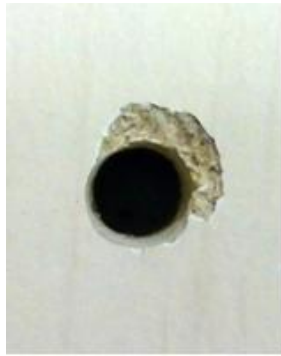
Рис. 2. Дефект обработки сверлением
