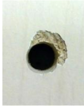
Рис. 2. Дефект обработки сверлением
