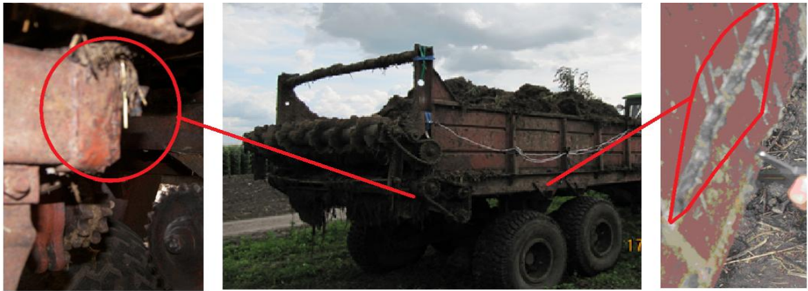
Рис. 1. Експлуатаційна дефектність типів тріщин несучої системи розкидача ПРТ-9
