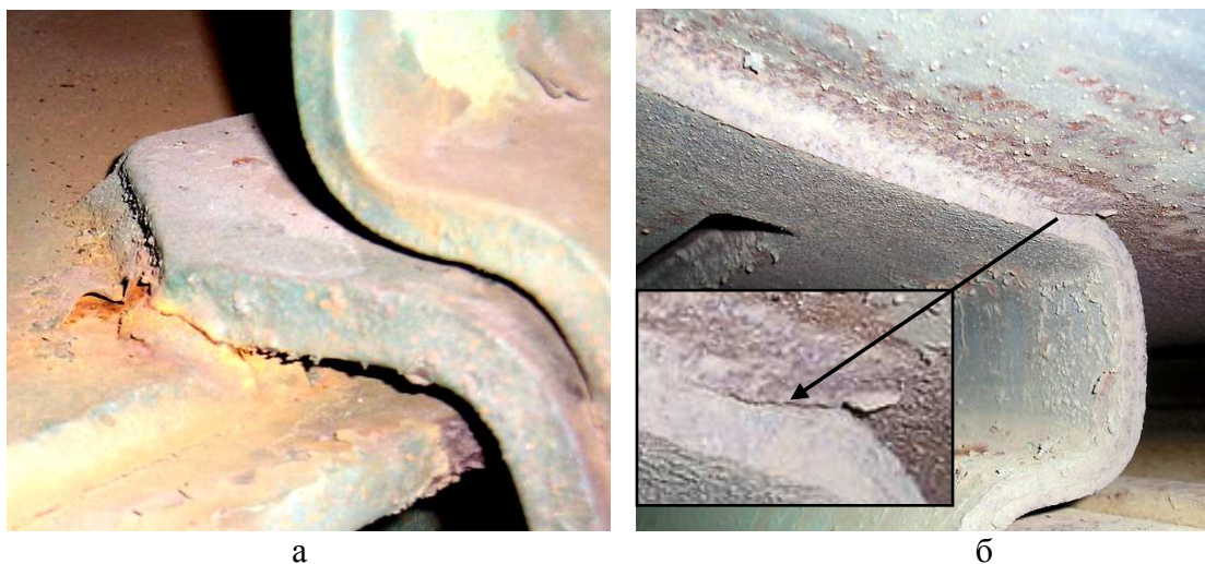
Рис.2. а) зона сварного шва рамной лапы в месте крепления к хребтовой балке б) зона сварного шва в месте крепления фасонной лапы к котлу.
